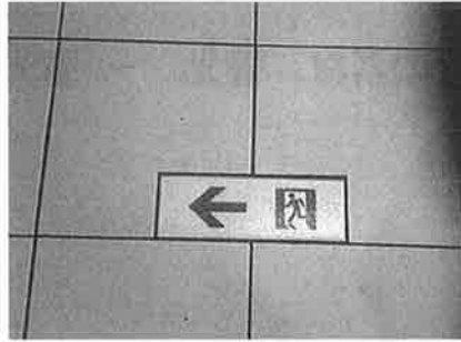
b) 床に設置したタイル状の明示物
